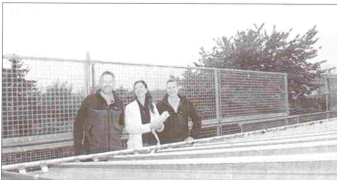
Auf dem Dach des Vorbaus verschafften sich Bürgermeister Eric Grabenbauer (links), Architektin Cecilia Orlandi und Markus Kustocz von der Gemeindeverwaltung eine Übersicht über den Fortgang der Dacherneuerung Fotos: du
